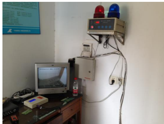
图 7-3 储源库监控设备、辐射监测设备
